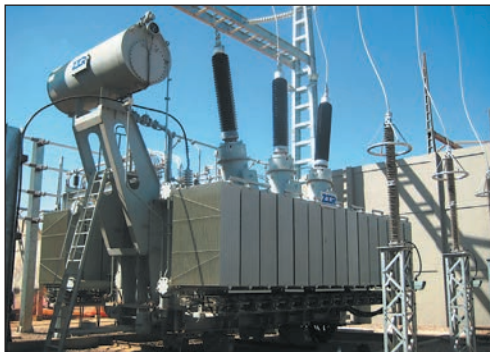
Мал. 9. Продукція ПАТ «Запоріж-трансформатор» використовується на генеруючих (теплові, атомні й гідроелектростанції), магістральних і розподільних (підстанції енергосистем) підприємствах. Її постачають у більше ніж 75 країн світу.
